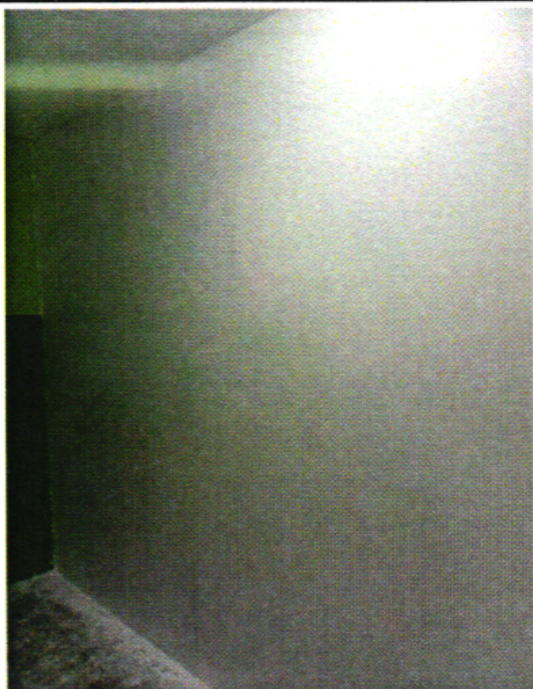
ESCOLA MUNICIPAL INACIO GOMES - PAREDE EM BLOCOS DE GESSO
