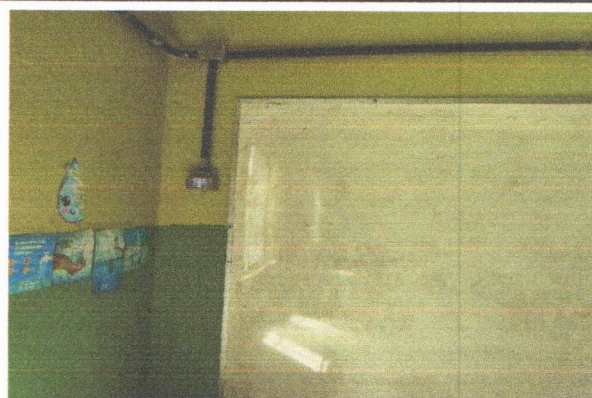
ESCOLA MUNICIPAL INÁCIO GOMES DA SILVA - CONDULETE METÁLICO E LUVA 3/4" PARA A INFRAESTRUTURA DO CIRCUITO DE TOMADAS E ILUMINAÇÃO)
