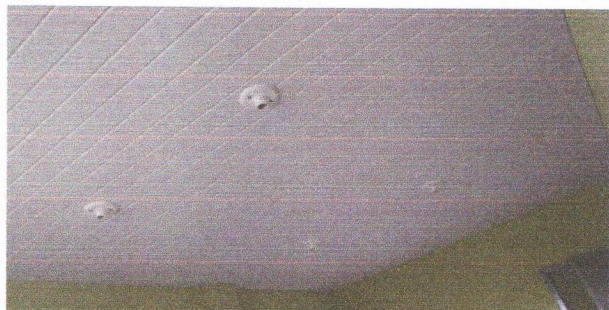
ESCOLA MUNICIPAL FRANCISCO TAVARES - PONTO DE ILUMINAÇÃO COM PLAFON
