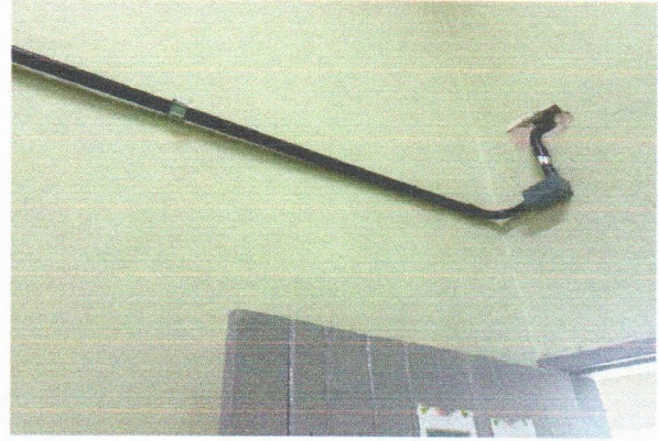
ESCOLA MUNICIPAL APOLÔNIO SALES - INFRAESTRUTURA DOS CIRCUITOS
