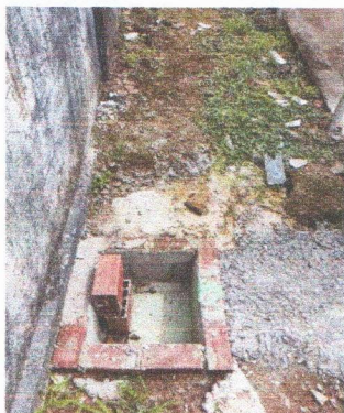
ESCOLA MUNICIPAL FRANCISCO TAVARES - CAIXA DE PASSAGEM
