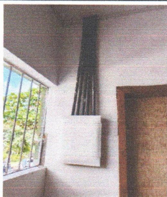
ESCOLA MUNICIPAL SENADOR FRANCISCO GOMES DE ARAÚJO - QUADRO DE DISTRIBUIÇÃO
