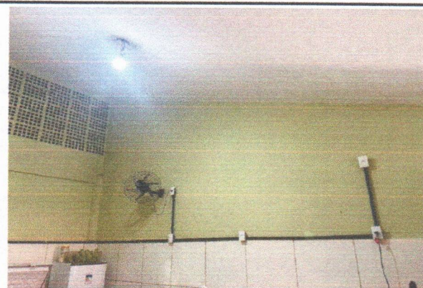
ESCOLA MUNICIPAL APOLÔNIO SALES - PONTOS ELÉTRICOS
