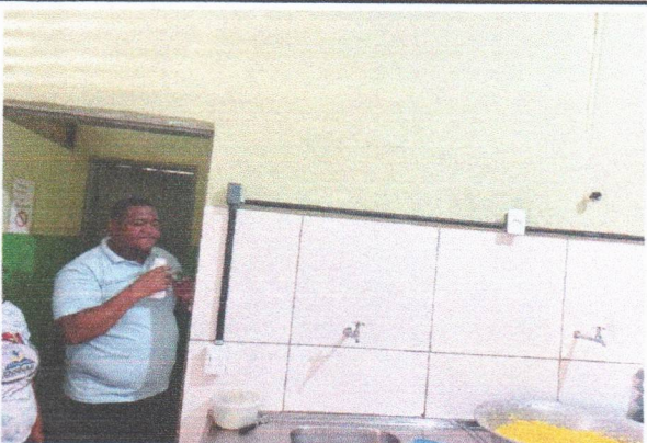
ESCOLA MUNICIPAL APOLÔNIO SALES - PONTOS ELÉTRICOS
