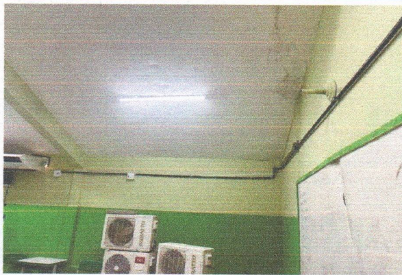
ESCOLA MUNICIPAL APOLÔNIO SALES - PONTOS ELÉTRICOS
