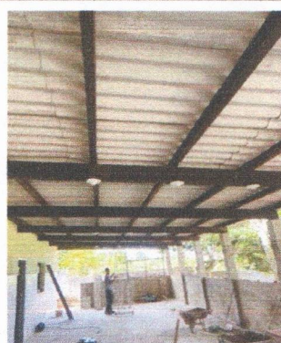
ESCOLA MUNICIPAL FRANCISCO TAVARES - PONTO DE ILUMINAÇÃO COM PLAFON
