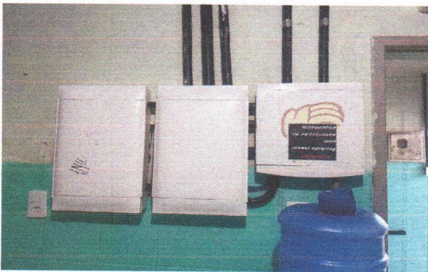
ESCOLA MUNICIPAL CLODOALDO GOMES DE ARAUJO ( ELETRICA )
