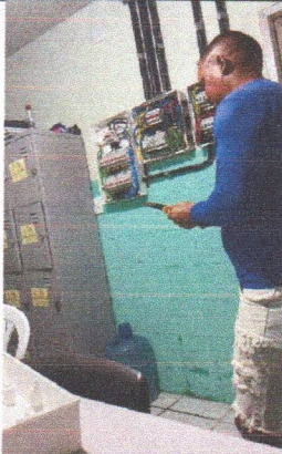
ESCOLA MUNICIPAL CLODOALDO GOMES DE ARAUJO ( ELETRICA )
