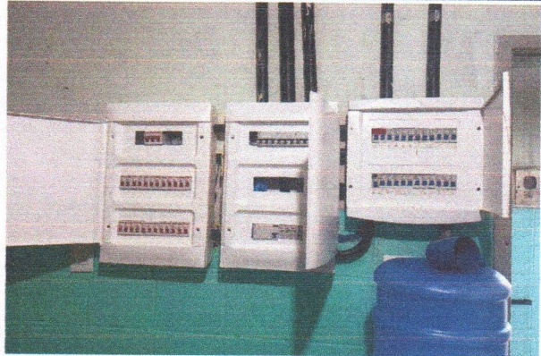
ESCOLA MUNICIPAL CLODOALDO GOMES DE ARAUJO ( ELETRICA )
