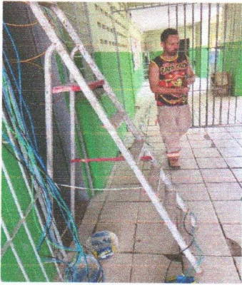
ESCOLA MUNICIPAL INACIO GOMES ELETRICA AR CONDICIONADO
