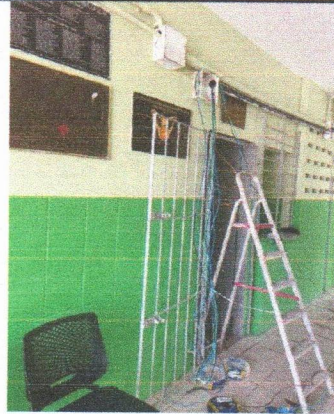
ESCOLA MUNICIPAL INACIO GOMES ELETRICA AR CONDICIONADO
