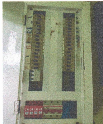
ESCOLA MUNICIPAL INÁCIO GOMES DA SILVA - DISJUNTOR TRIFÁSICO 80A
