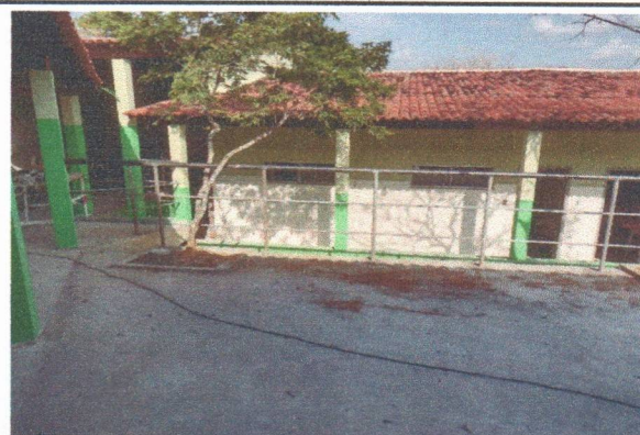
ESCOLA MUNICIPAL FRANCISCO TAVARES - GUARDA-CORPO
