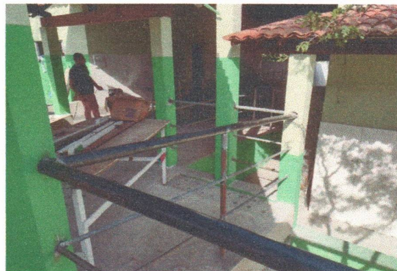
ESCOLA MUNICIPAL FRANCISCO TAVARES - GUARDA-CORPO
