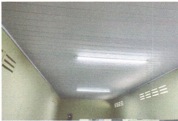
ESCOLA MUNICIPAL TIRADENTES - LUMINÁRIAS
