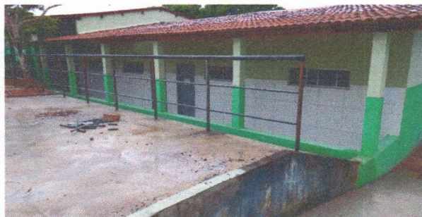
ESCOLA MUNICIPAL FRANCISCO TAVARES - GUARDA-CORPO
