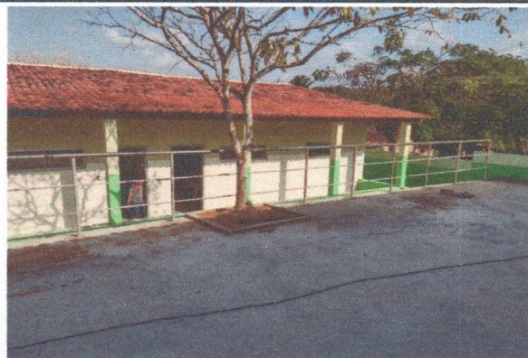
ESCOLA MUNICIPAL FRANCISCO TAVARES - GUARDA-CORPO
