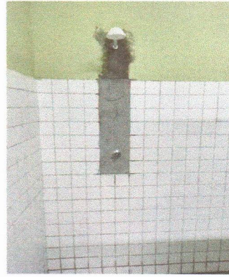
ESCOLA MUNICIPAL TIRADENTES - CHUVEIRO E REGISTRO
