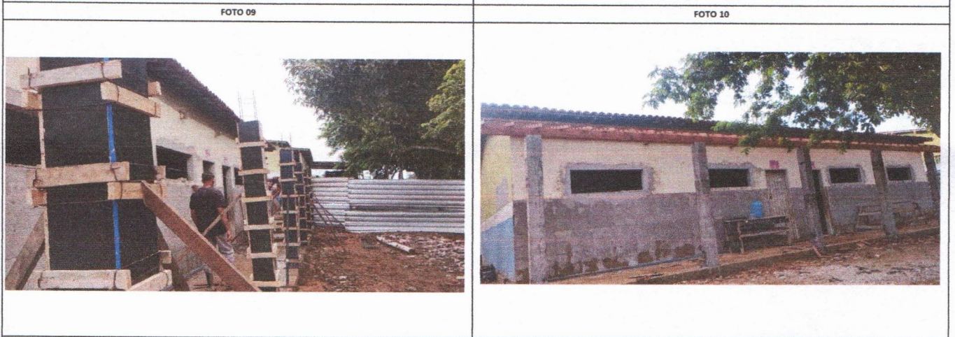
ESCOLA MUNICIPAL FRANCISCO TAVARES - EXECUÇÃO DE PILARES ESCOLA MUNICIPAL FRANCISCO TAVARES - EXECUÇÃO DE PILARES
