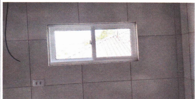
REVESTIMENTO CERÂMICO NAS PAREDE E JANELA DE ALUMÍNIO DE CORRER (ANEXO FUNDOS)
