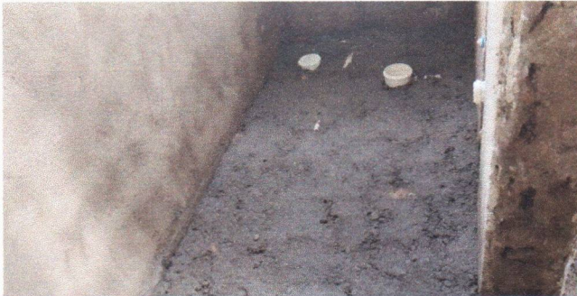
LASTRO DE CONCRETO MAGRO, PONTOS DE ÁGUA E PONTOS DE ESGOTO (ANEXO FUNDOS)
