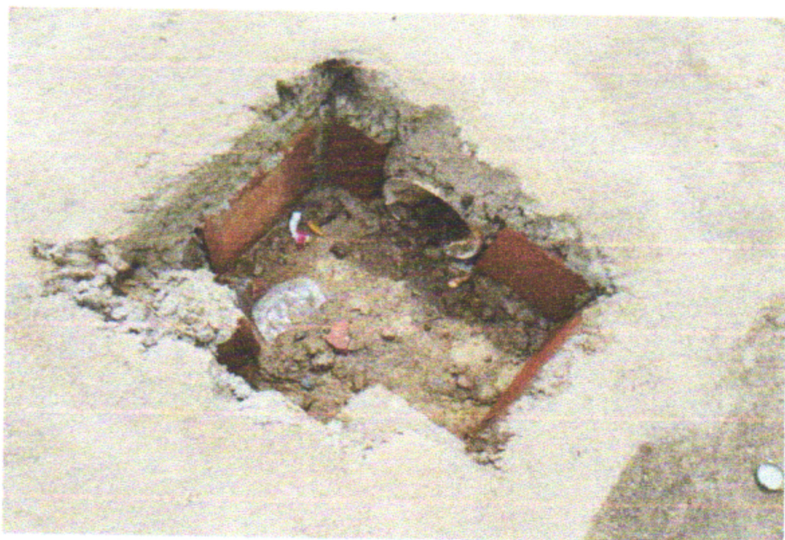
TUBO DE PVC DN 150MM NA CALÇADA (PASSAGEM DE ÁGUA PLUVIAL)
