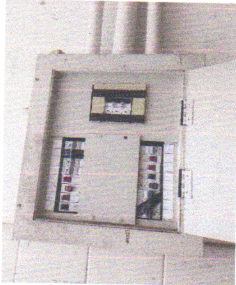
QUADRO DE DISTRIBUIÇÃO
