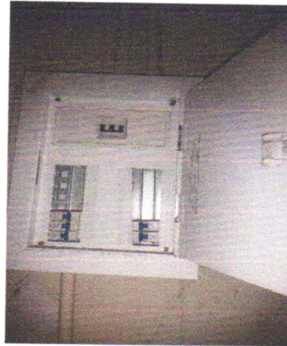
QUADRO DE DISTRIBUIÇÃO
